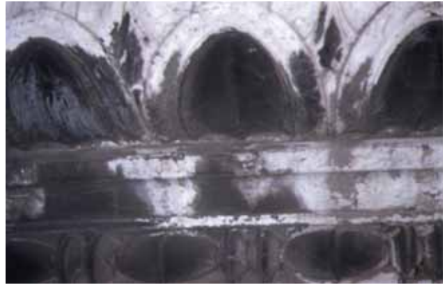
Fig. 2 Particolare dell'annerimento superficiale alla base di una colonna in Botticino. Detail of surface blackening at the column base in Botticino limestone.
