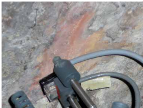
Fig. 2 Installazione del sensore di temperatura a contatto sulla volta della cappella Major nella Cattedrale di Santiago di Compostela (Spagna). Surface Contact temperature sensor installed at the Cappella Major of the Santiago de Compostela Cathedral (Spain).
